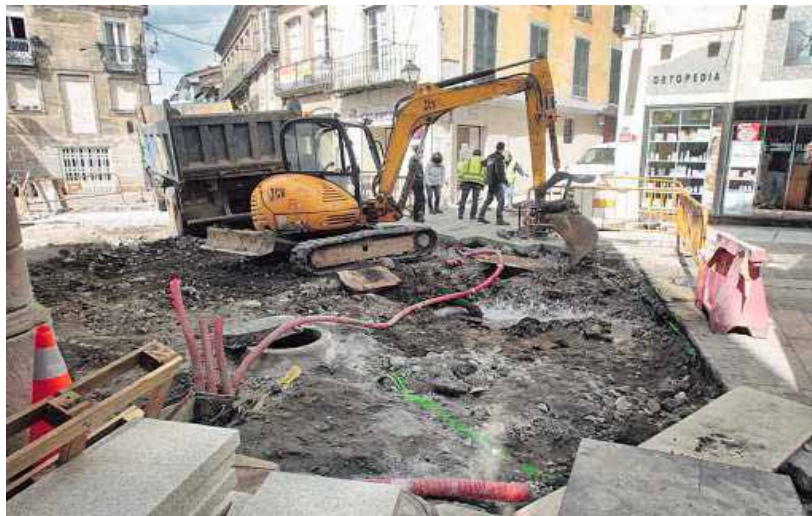
Fotografía de archivo de la reparación de un reventón en una tubería de agua en el centro de Monforte. c.c.
